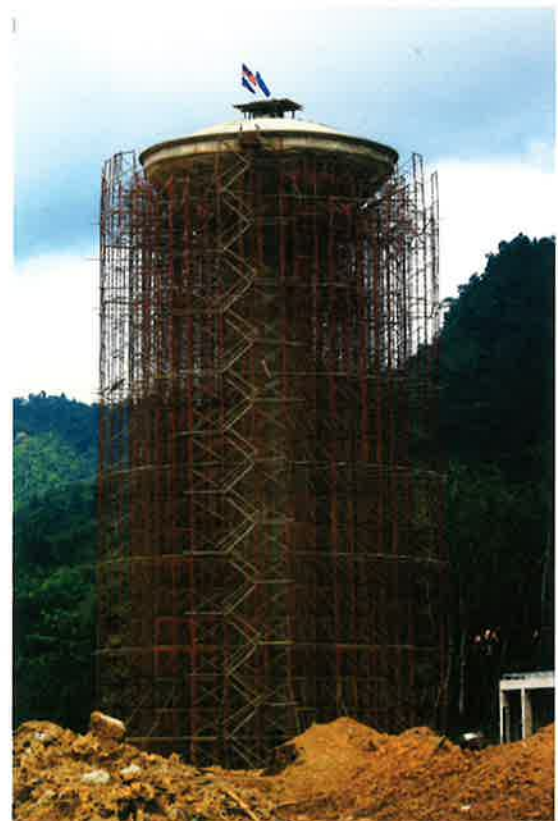
d) Tangki air dengan ketinggian 36 meter.
